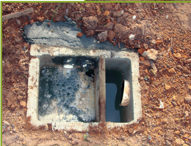
Imagem 6: Caixa de gordura na parte superior da caixa
