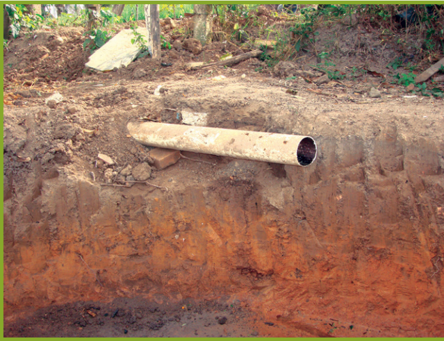
Imagem 3: Tubo de entrada de esgoto
