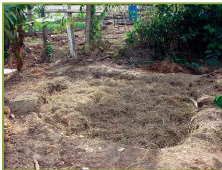
Imagem 9: Vala totalmente preenchida com capim seco
