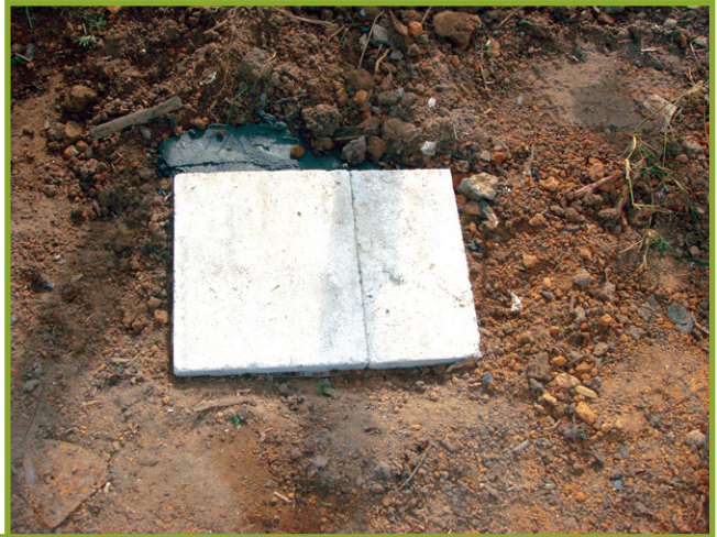
Imagem 5: Caixa de gordura
