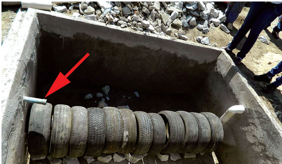
Imagem 17: Tubo ladrão (tubo do lado esquerdo)
