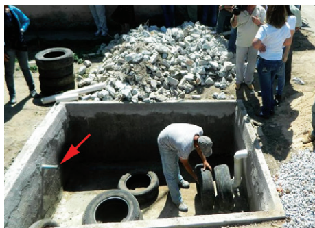
Imagem 18 Tubo ladrão (tubo do lado esquerdo)
