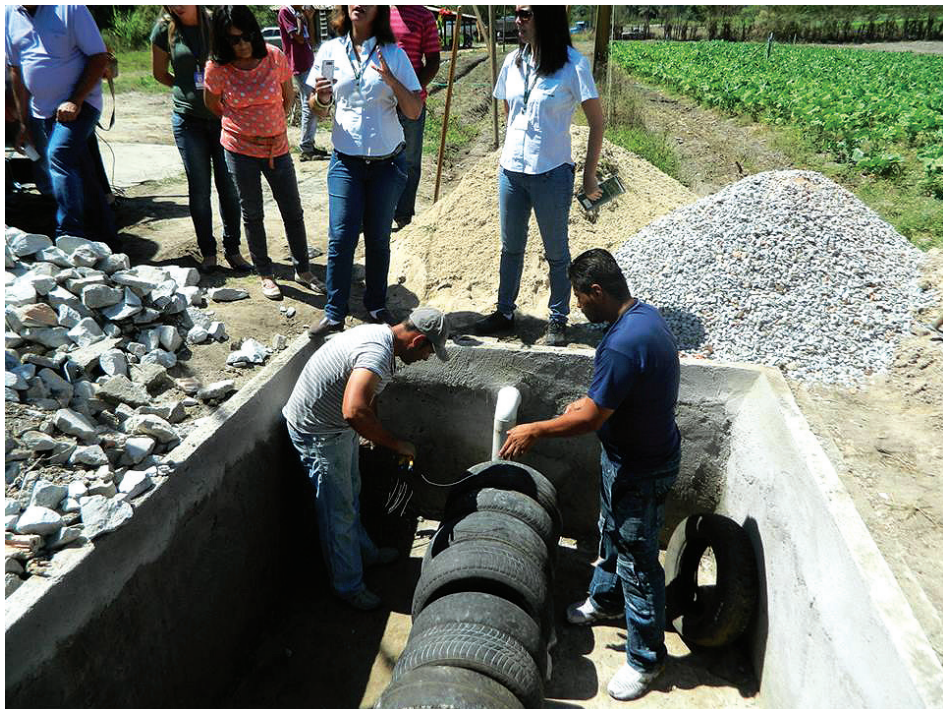
Imagem 15: Tubo de entrada do efluente posicionado para dentro da câmara anaeróbia
