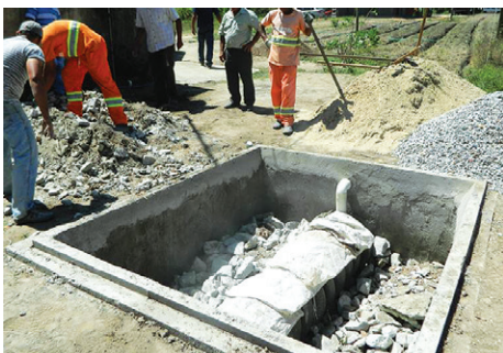
Imagem 4: Tubo de entrada do esgoto
