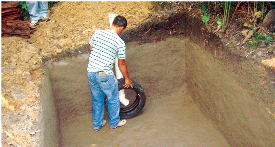
Imagem 3: Tubo de entrada do esgoto
