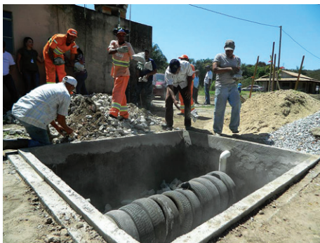
Imagem 14: Tubo de entrada do efluente posicionado para dentro da câmara anaeróbia
